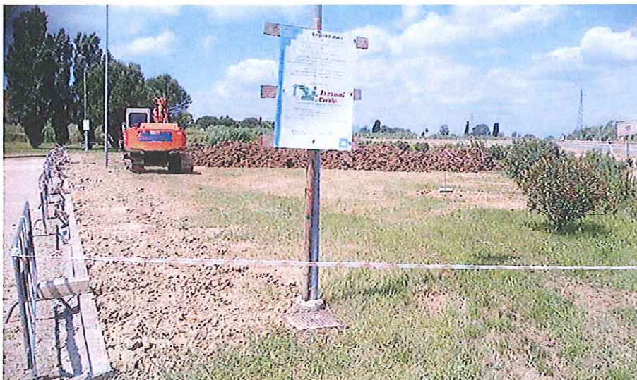
Ruspeal lavoro, al campo di Ponte a Elsa, per la realizzazione di un nuovo impianto per giocare le partite, di calcio a 7, delle squadre della Scuola calcio
